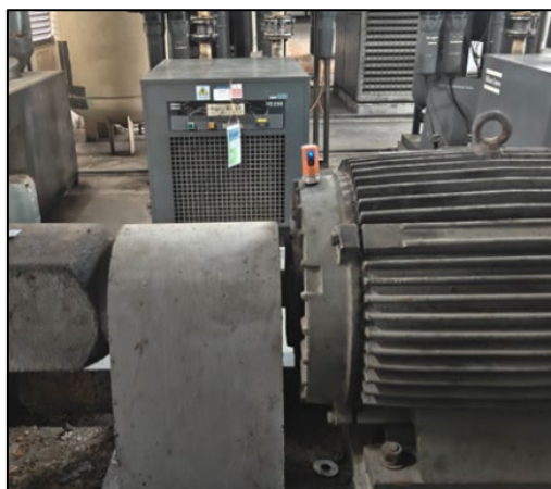
図 10:設備にセンサを設置
