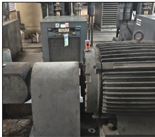
図 10:設備にセンサを設置
